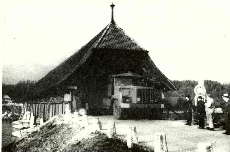
WANGEN, essais de charge avec un camion de 38 tonnes à trois essieux, le fléchissement max. étant de 1,2cm; ce résultat a été obtenu grâce aux renforcements diagonaux en 1934, qu'on voit sur la photo #3, des deux côtés du pilier.
