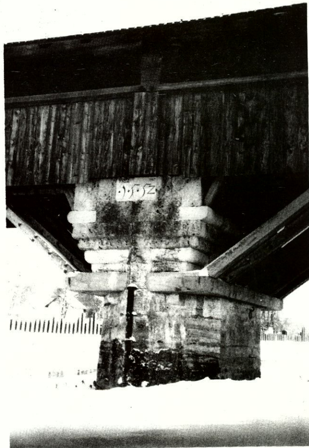
WANGEN, le pilier en maçonnerie date de 1552, sa fondation a été renforcée en 1967 par des palplanches métalliques; dans la même année les piliers en bois ont été remplacés par des piliers en béton armé parce que la construction d'une usine électrique a occasionné la levée du niveau d'eau
