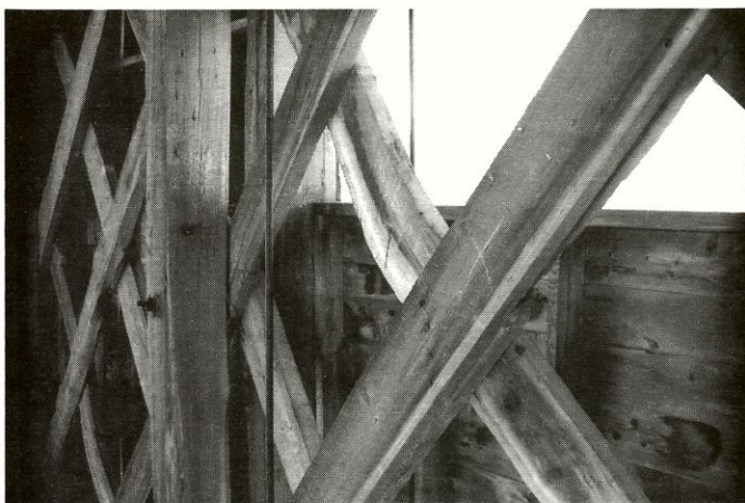
Des dommages importants au pont Taschereau. Photo: André Cloutier ©
