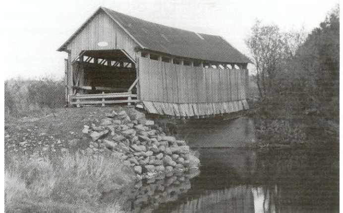
Remarquez les pierres déversées afin de stabiliser la culée ouest. Photo: Léo Bonin ©
