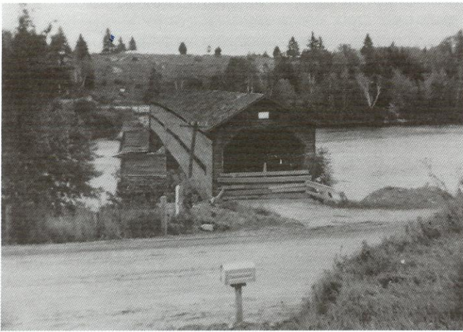
Les travaux de démolition sont complétés sur la portion de la structure appartenant à Mont-Laurier. Collection Richard Sanders Allen.
