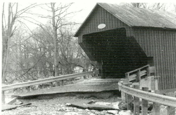
Le 19 janvier 1996, le pont Freeport (61-45-02) était inaccessible à cause des fortes pluies qui ont détruit la route. Pierre Duff ©.
