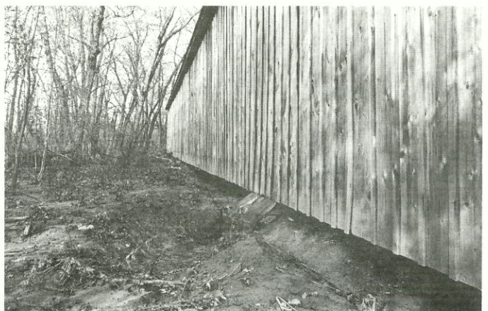
Le pont Locust Creek (25-58-01), au Missouri, ensablé lorsque la rivière a dévié de son cours. Photo: Gérald Arbour.©
